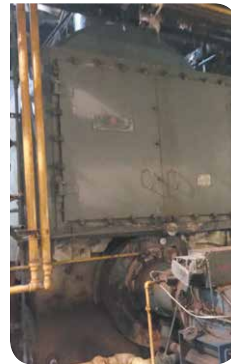
Una de las calderas antiguas de NYCHA.
