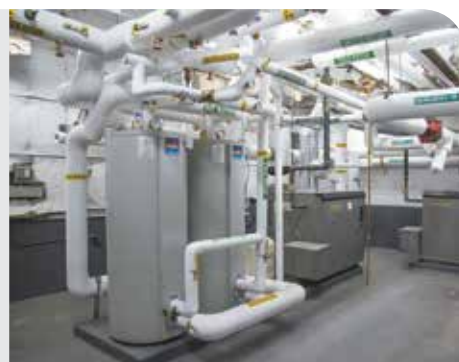
Un ejemplo de las nuevas calderas y sistemas de calefacción.
