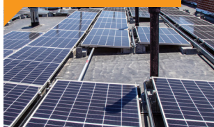
НОВЫЕ СОЛНЕЧНЫЕ ПАНЕЛИ 572 WARREN STREET
