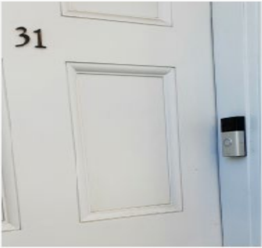
EXISTING DOOR INTERCOM NTS
