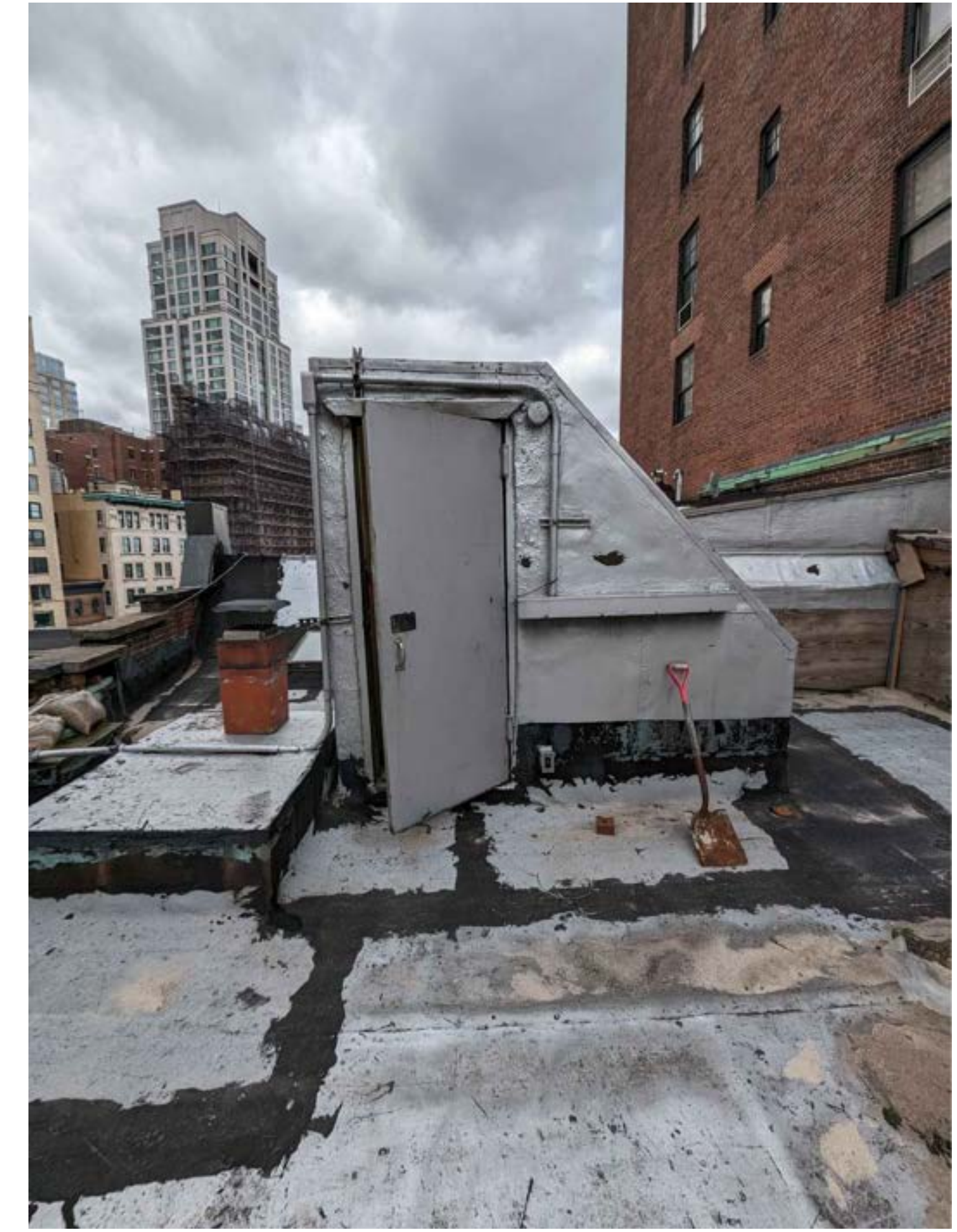
4 PHOTO OF EXISTING BULKHEAD SCALE: N.T.S.
