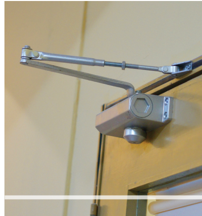
Portes à fermeture automatique
