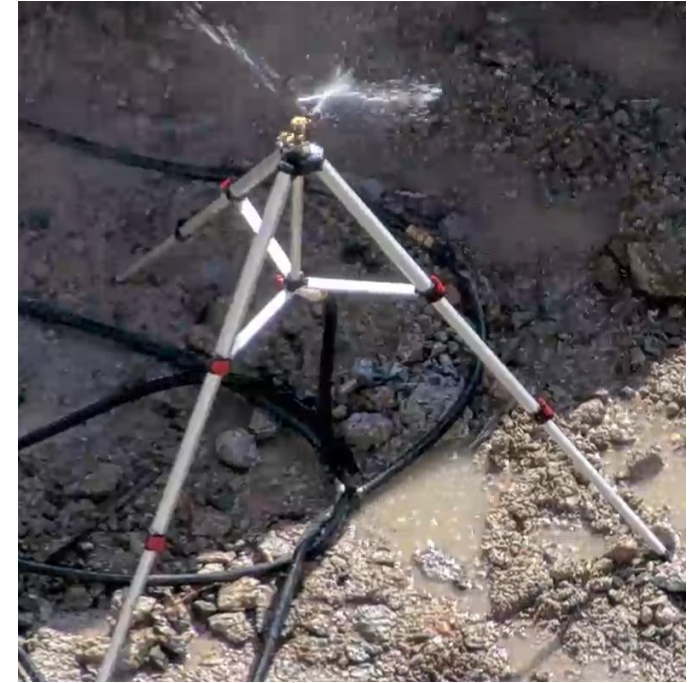
Dust Control Sprinkler 粉塵控制噴灑系統
