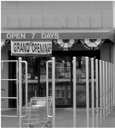
Les portiques à chariots limitent l'accès au magasin des utilisateurs en fauteuil roulant.
